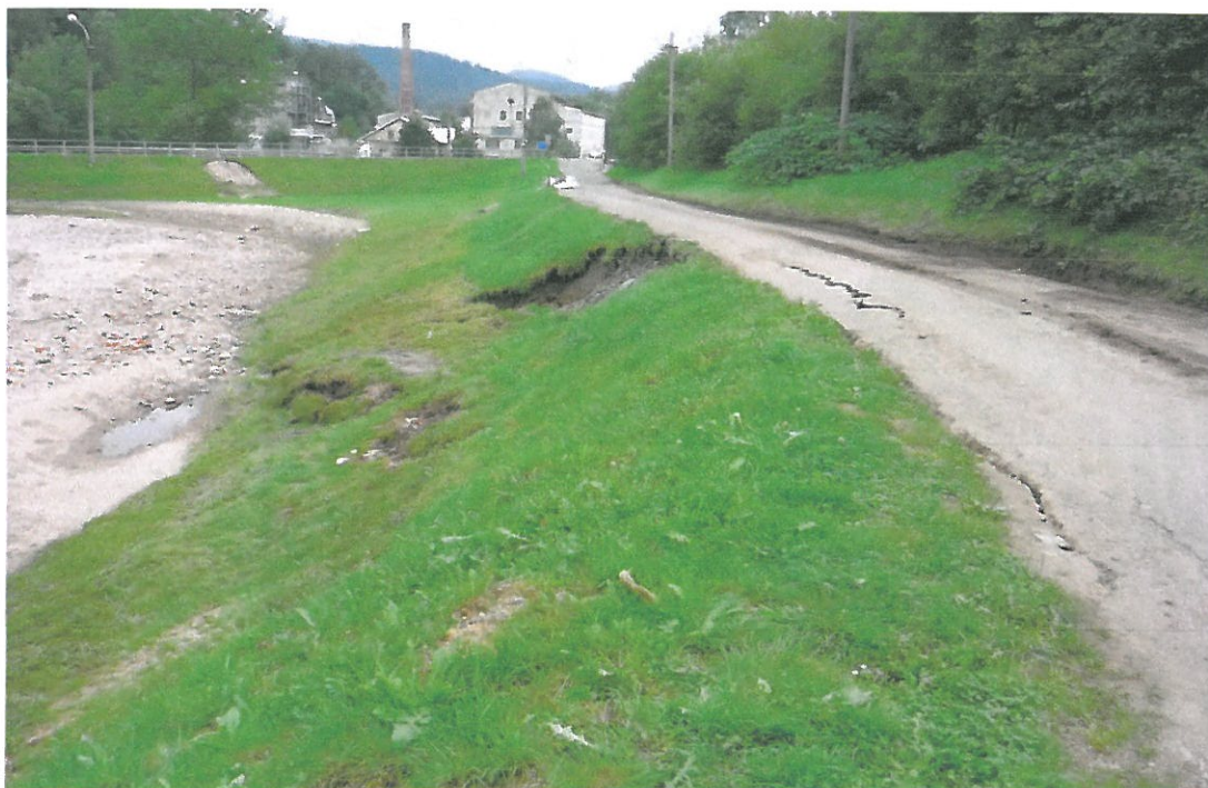
Obr. č. 31 Sesuv zeminy a poškozená komunikace v ul. Zadní
