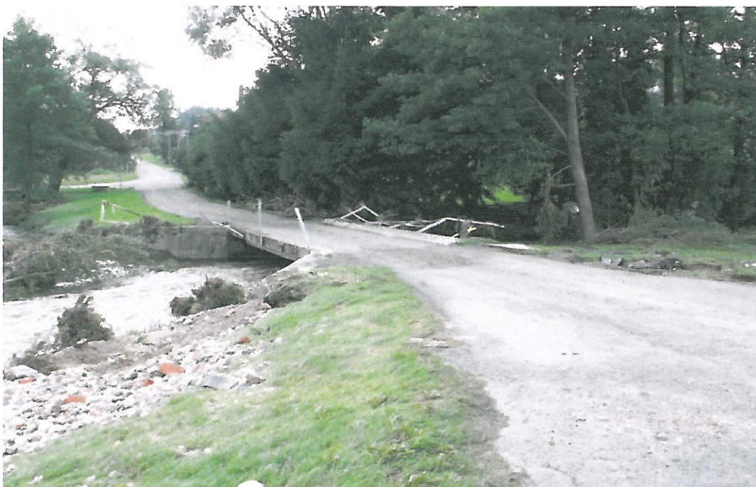
Obr. č. 24 Poškozený most v ul. Spojovací pod budovou Obecního úřadu Mníšek
