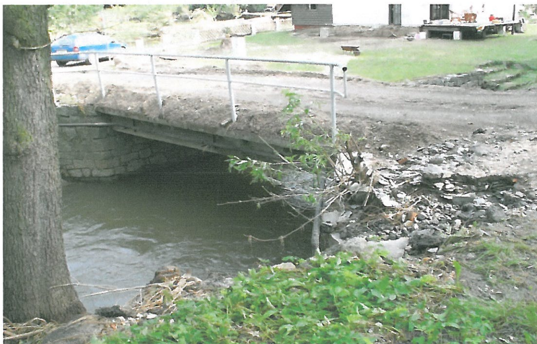
Obr č. 26 Poškozený most v ul. U Potoka v Mníšku
