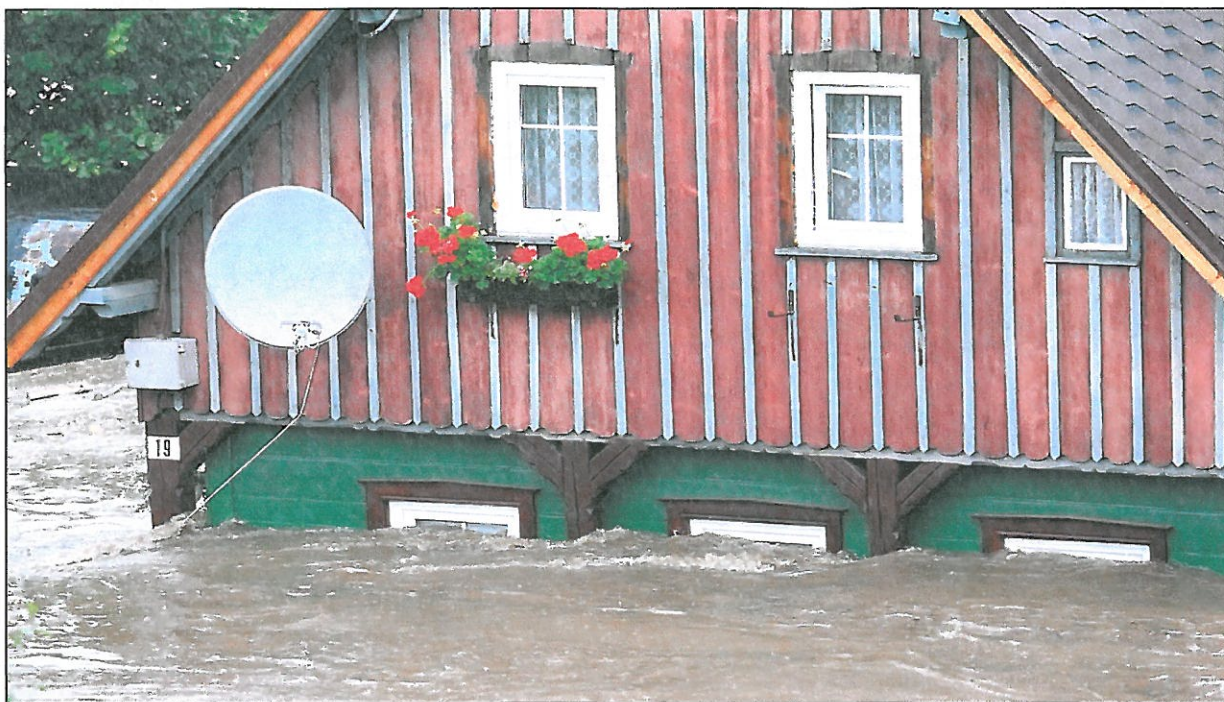
Obr. č. 13 Zaplavená část obce Mníšek směrem na N. Ves – při kulminaci 2. povodňové vlny - dům čp. 19
