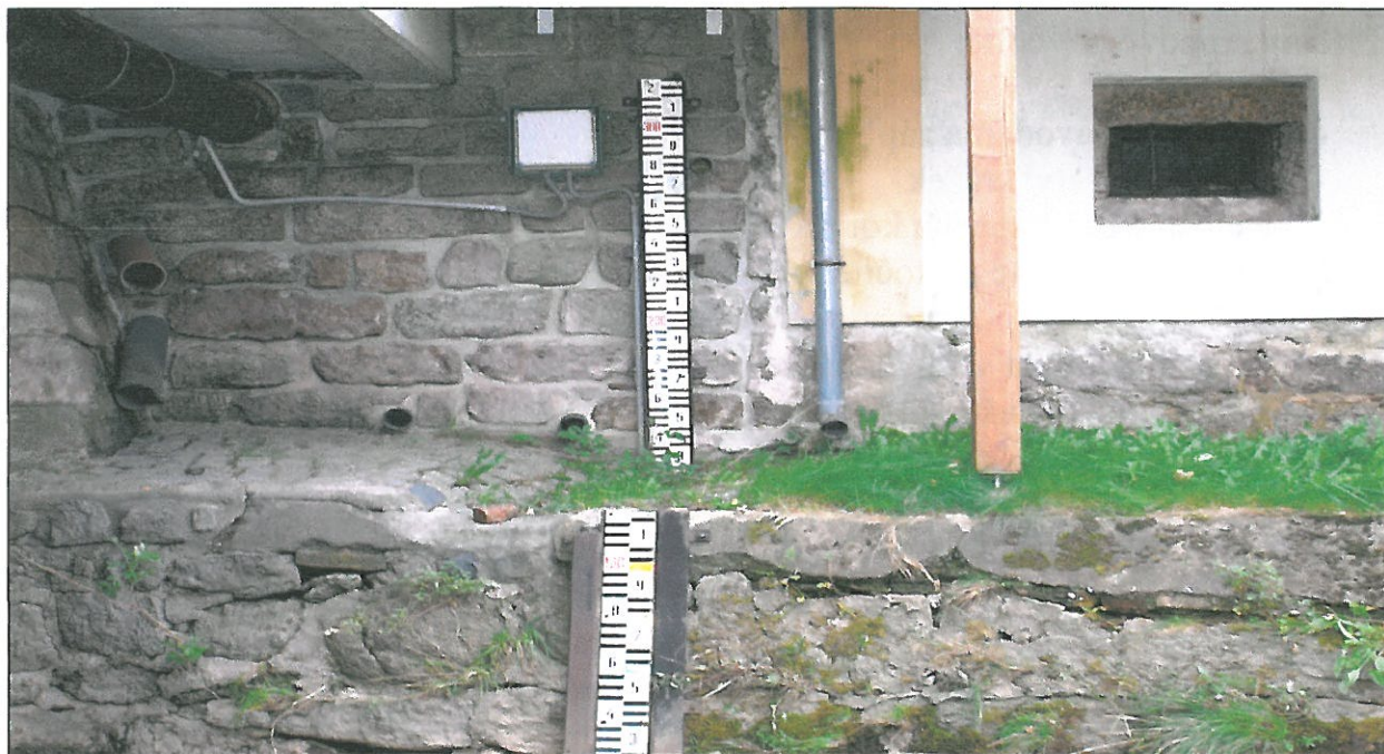
Obr. č. 3 Měrná lať u mostu přes Jeřici s měřidlem do 3,20 m.
