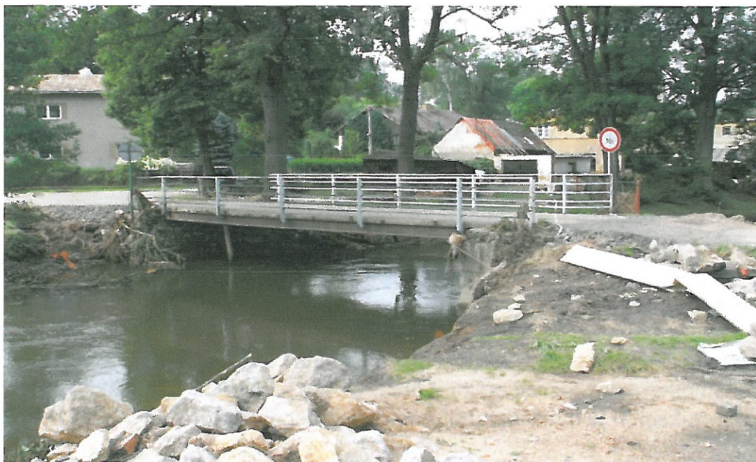
Obr. č. 23 Poškozený most u čp. 206 v Mníšku
