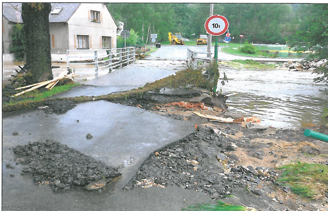
Obr. č. 32 Poškozená komunikace u mostu v ul. Ke Křížkům u čp. 206
