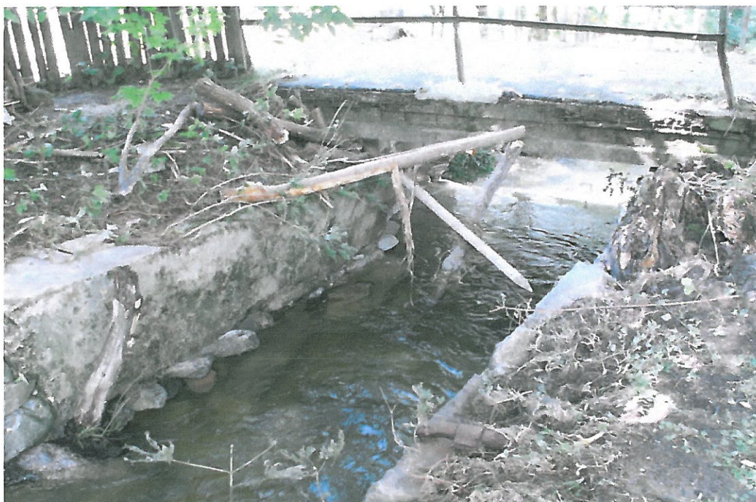
Obr. č. 25 Poškozený most v ul. K Pekárně ve Fojtce
